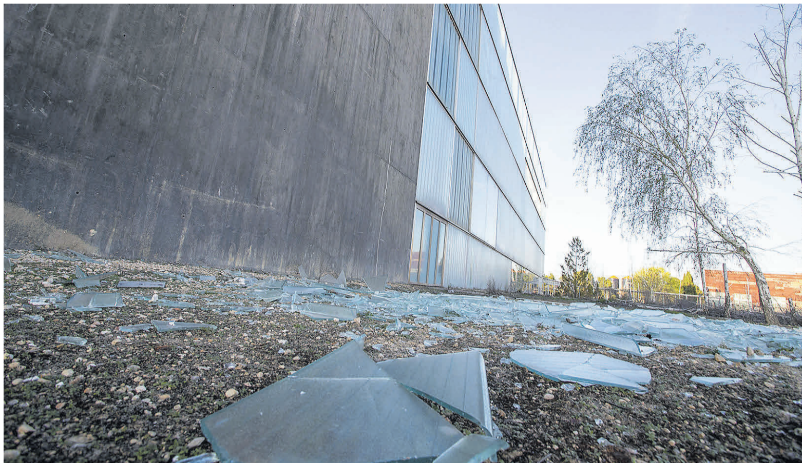
Imagen del exterior del Palacio de Congresos con cristales rotos de las ventanas sobre el suelo. // JOSÉ MIGUEL ESPARCIA
